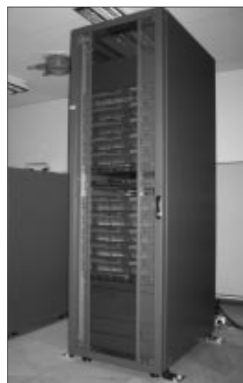
写真1 1280PEを搭載したBioServer第2号機のラック
